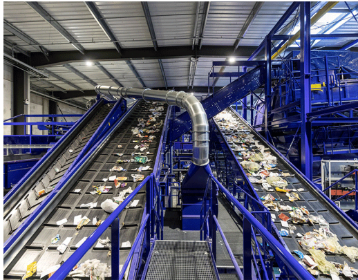
Nouveau Centre de Tri - Illats (33)
